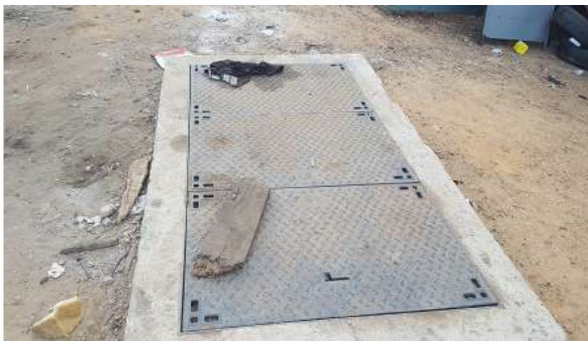
Vue d'une installation de téléphonie
