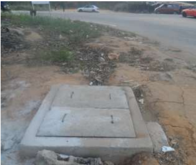
Vue d'un équipement d'adduction en eau potable
