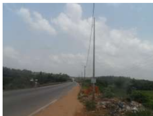
Vue des installations enterrées de la CIE
