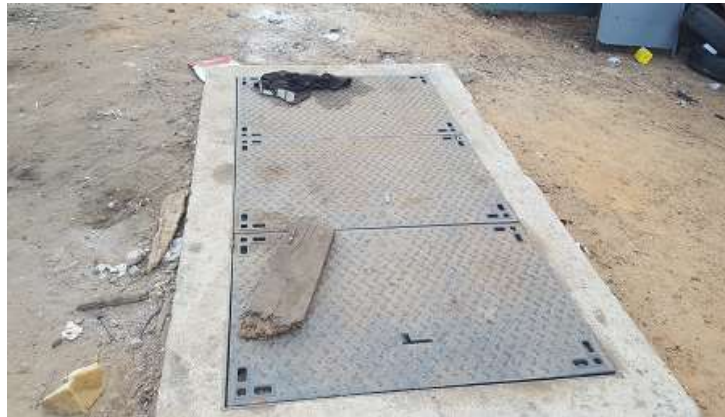
Vue d'une installation de téléphonie (Source : Merheb, 2019)
