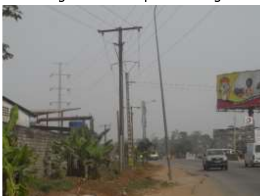
Vue de lignes de transport d'énergie HT
